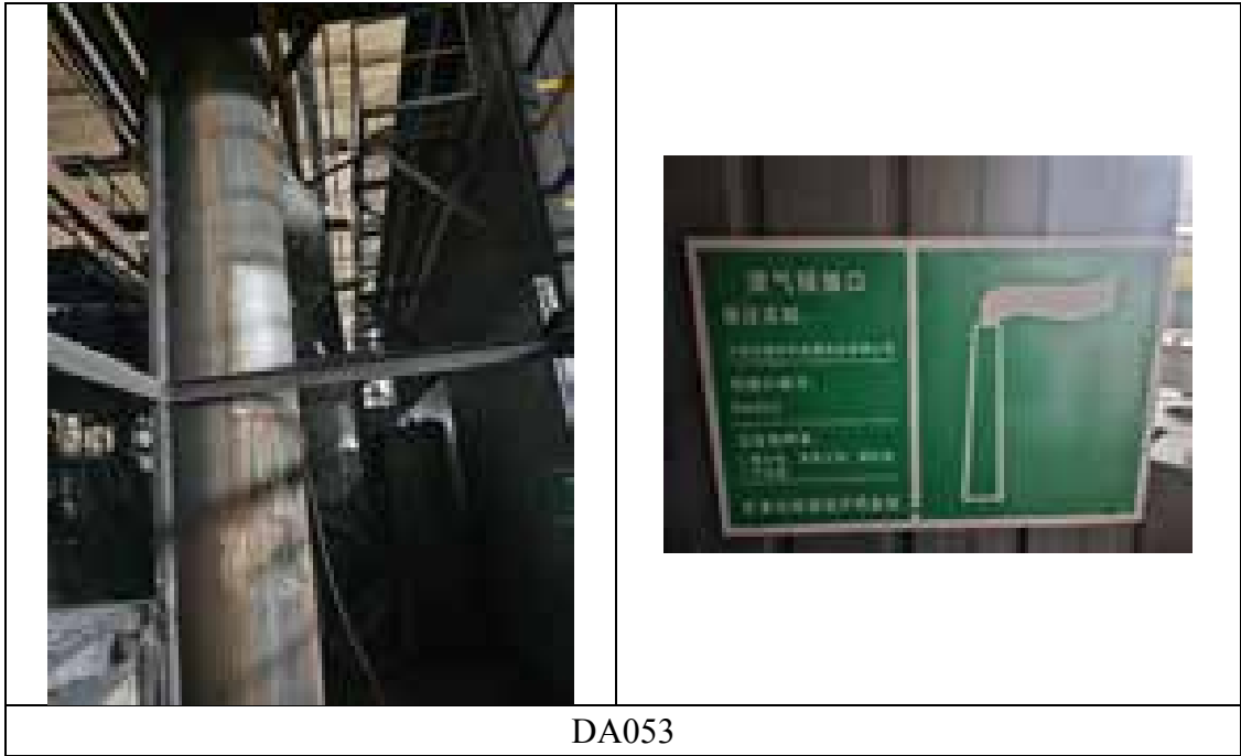
图 2.4-1 厂区现有环保设备照片
